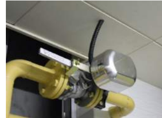
▲ 가스누설경보기의 차단밸브가 설치된 사례
