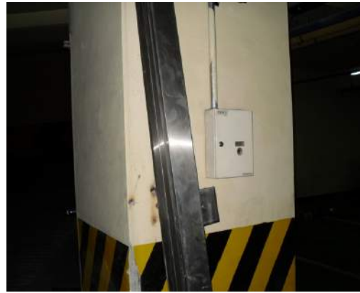
▲ 방화셔터 레일이 파손된 상태로 방치한 경우
