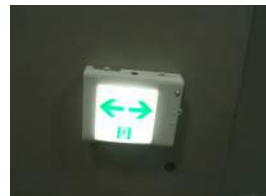
▲ 통로유도등이 올바르게 설치된 경우
