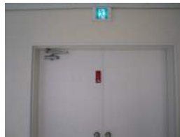
▲ 피난구 유도등이 올바르게 설치된 경우
